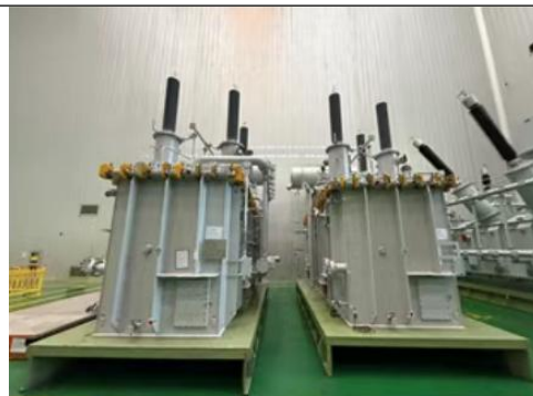
图13: 浙变电气美国德州 130MVA 变压器扩建项目产品
