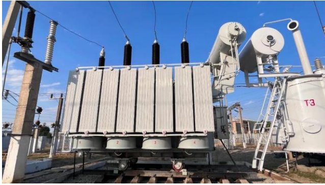
图33: 塔吉克斯坦项目: SFSZ11-40000110 变压器
