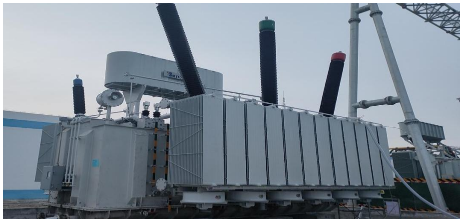
图32：中核汇能甘肃金塔汇升330kV主变项目
